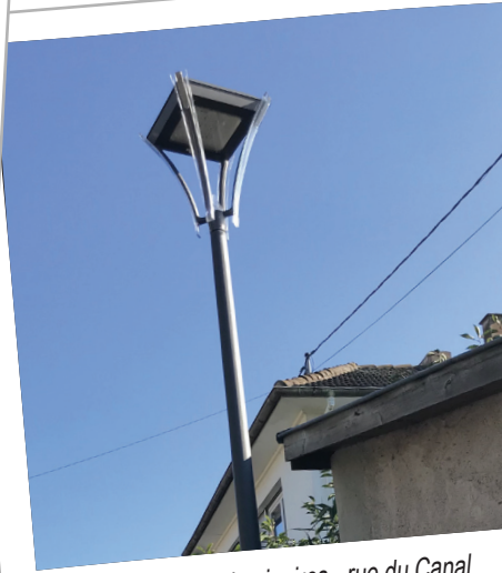
Nouveaux luminaires - rue du Canal
